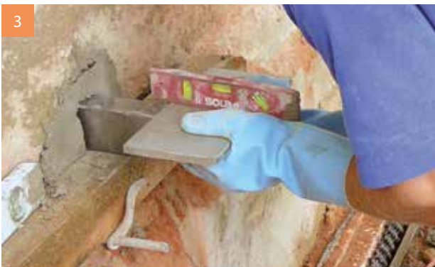
3 Die Bohrlöcher werden hohlraumfrei mit Montagemörtel ausgefüllt. Anschließend werden die Konsolen mittig in das ausgemörtelte Bohrloch gesetzt.
