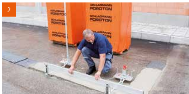
2 Abziehen: Ausgehend vom höchsten Punkt wird ein ca. 1,5 cm dickes vollflächiges Mörtelbett für die erste Ziegelschicht angelegt. Der Nivelliermax ermöglicht ein millimetergenaues Abziehen des Mörtelbettes mit der Messlatte.
