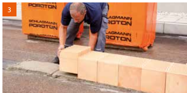
3 Erste Ziegelschicht: In das noch feuchte Mörtelbett wird die erste Ziegelschicht versetzt und ausgerichtet. Das exakte Einrichten der ersten Ziegelschicht auf Ebenflächigkeit ist mit größter Sorgfalt durchzuführen und durch Auflegen einer 3–4 m langen Alulatte zu überprüfen und ggf. zu korrigieren.
