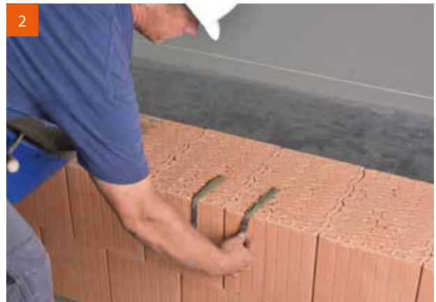
Einsetzen der in Dünnbettmörtel eingetauchten Flachstahlanker. Um Verletzungen vorzubeugen, werden die Anker umgebogen eingesetzt.
