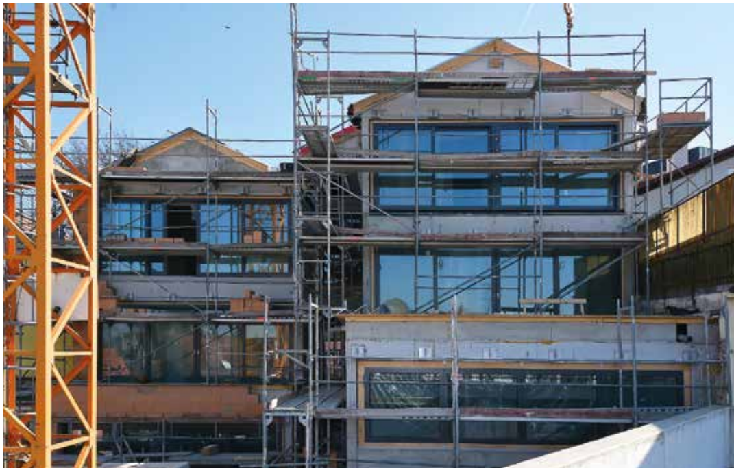
Betonbauteile müssen häufig gedämmt werden, um die schlechtere Wärmedämmung von Beton auszugleichen.
